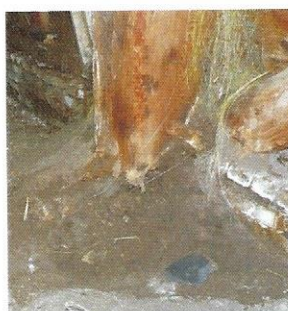
Onderzijde staander spant 1 geheel ingezakt wat leidt tot zichtbare verzakking gevel
