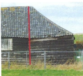
Ter plaatse van spant 1 is de gevel verzakt.
